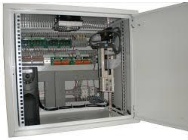
типовой шкаф высокой готовности
